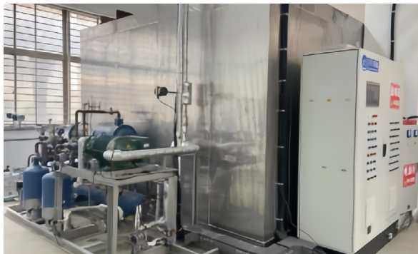
低温制冷实验室制冷空调设备平台
